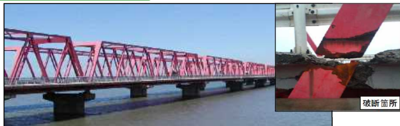
トラス橋の斜材の破断(木曾川大橋)
