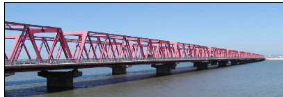
トラス橋の斜材の破断(木曾川大橋)
