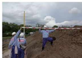
被災状況調査(堆積土砂)
