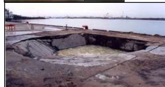
港湾施設エプロン部分の陥没
