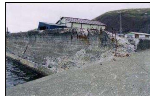
老朽化した海岸堤防
