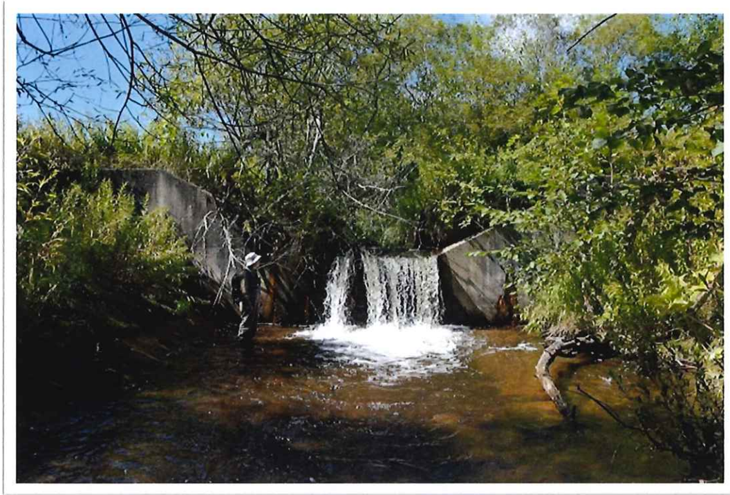
写真8. 魚道整備をおこなうイトウ、サクラマス、サケの遡上障害となっている落差工
