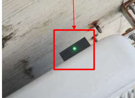
ボルト緩み有り(点灯)
