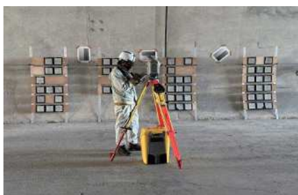
計測機器の設置、計測範囲等の設定
