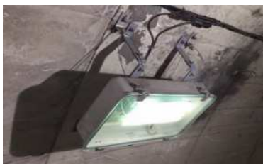
照明灯具(Aトンネル) 状態:健全
