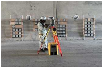
計測機器の設置、計測範囲等の設定
