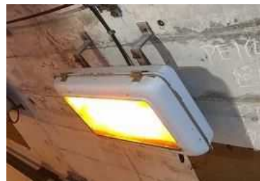
照明灯具(Bトンネル) 状態:表面腐食
