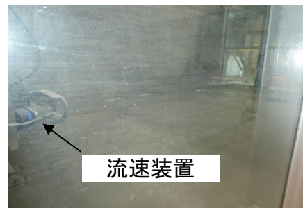
写真-13 流速装置(攪拌機)
