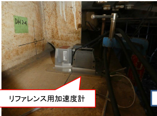
写真-6 リファレンス用計測機
