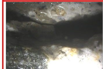
水平ひび割れ・2 (路面から143mm付近)
