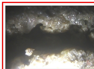
水平ひび割れ・1 (路面から60mm付近)
