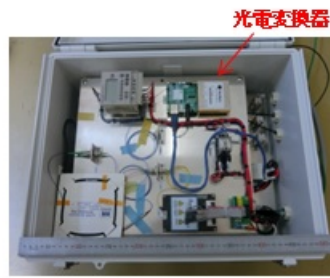
写真2 制御装置BOXの内部
