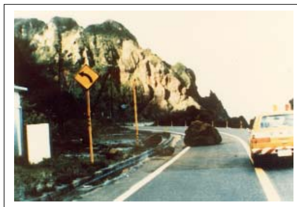
■岩内町雷電における落石状況
