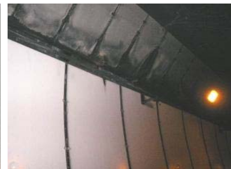
漏水(内装板上)
