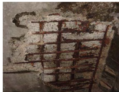
《床版下面損傷》
