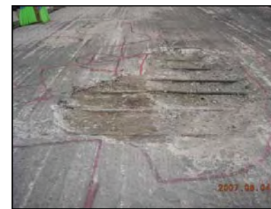
《床版上面損傷》
