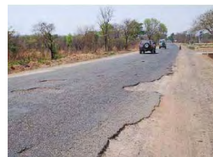
サブサハラ地域の道路損傷状況
