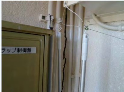
壁の亀裂(福島松川㊤)
