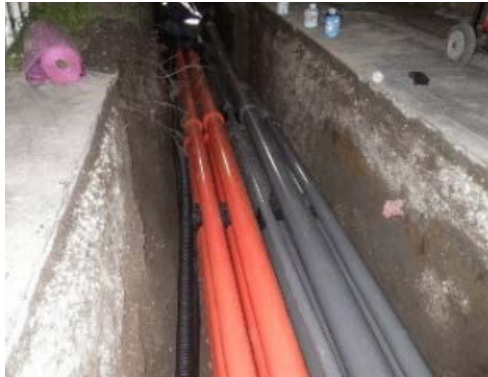
管路の事例(国内)
