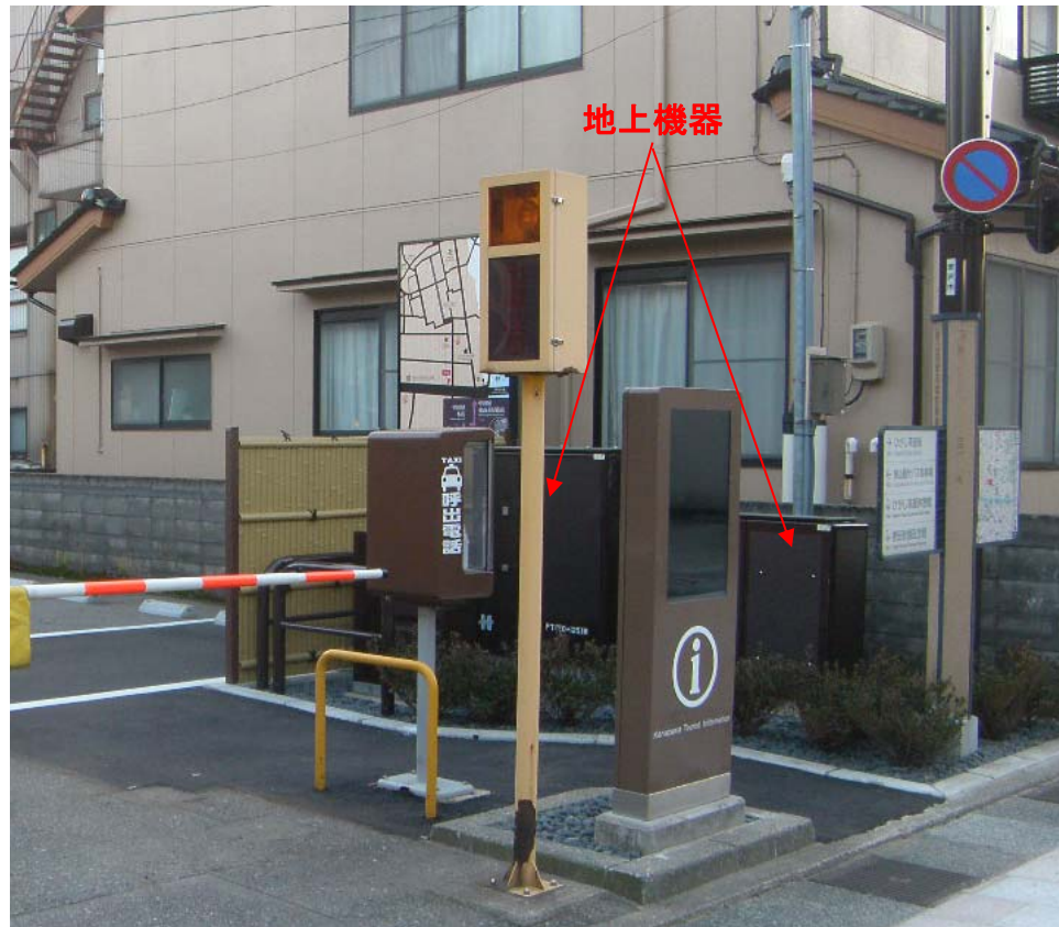
地上機器（変圧器・分岐器）の集中配置（3基）
