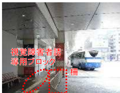
乗降場における視覚障害者誘導用ブロックや柵の設置
