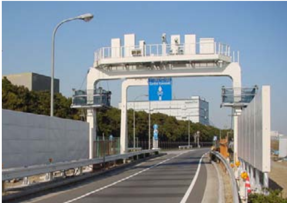
出口ETC機器(東扇島出口)
