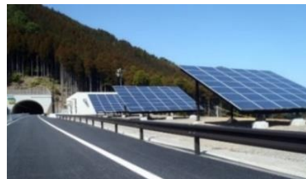
道路空間の太陽光発電設備
