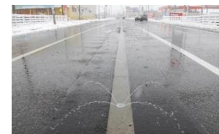
消融雪施設等の整備
