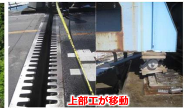
令和4年3月福島県沖地震 （国道399号（伊達橋）：福島県）
