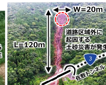
道路区域外の斜面山頂部 からの大規模崩落 国道3号 令和2年7月豪雨
