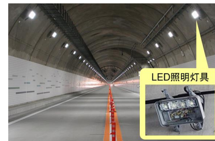
道路照明のLED化
