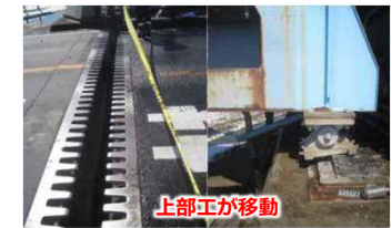
令和4年3月福島県沖地震 (伊達橋：福島県)
