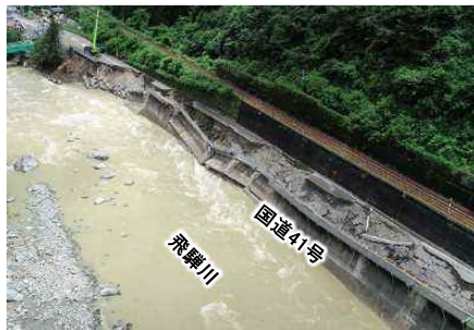
令和2年7月豪雨 国道41号
