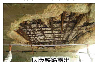
床版鉄筋露出
