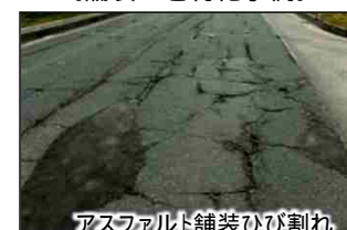
アスファルト舗装ひび割れ
