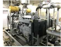
<自家発電装置>
