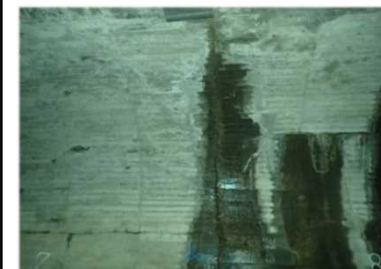
損傷状況(うき・漏水)
