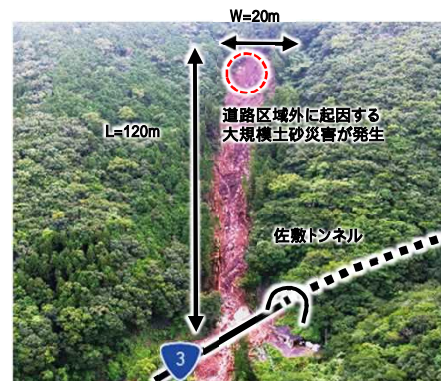
<斜面山頂部からの大規模崩落> 国道3号 令和2年7月豪雨
