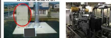
<無停電装置> <自家発電装置>
