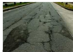
<劣化状況(国道)>
