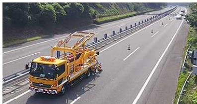
<規制機材の自動設置状況>
