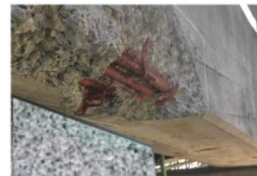
損傷状況(鉄筋露出)
