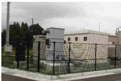
非常用発電機 27
