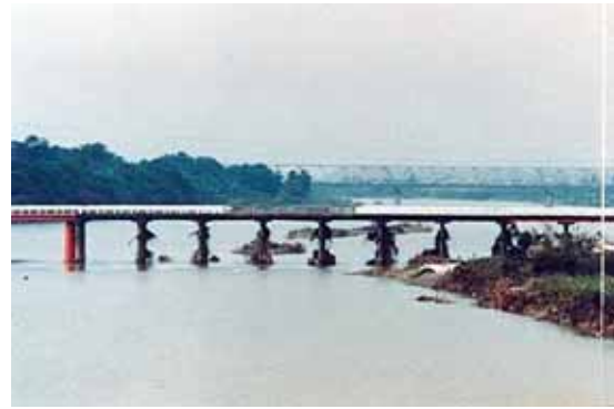
雲出川橋被害状況 昭和 57 年洪水
