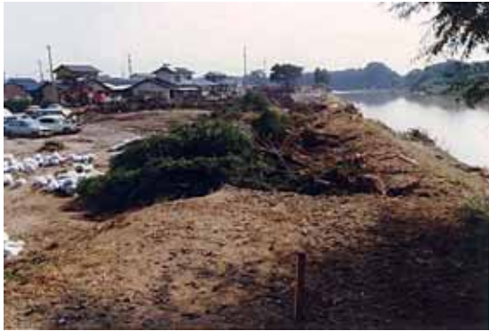
一志団地破堤箇所災害状況 昭和 57 年洪水
