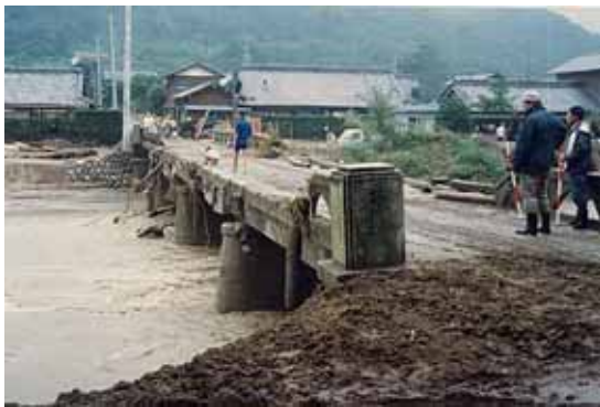
中村川井置橋被害状況 昭和 57 年洪水
