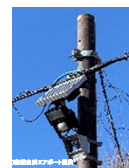
太陽光パネル付き LED照明
