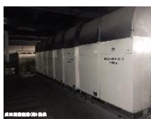
高効率型空調機
