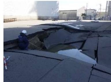
ふ頭用地の陥没(金沢港)
