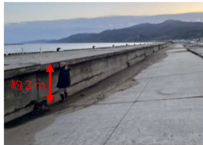
岸壁背後の沈下(輪島港)
