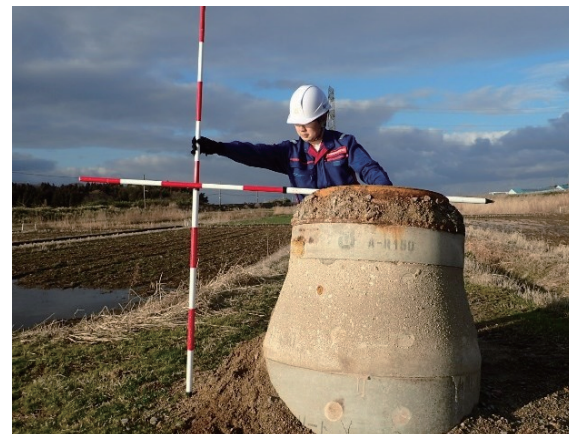
マンホール浮上現場（中能登町）
