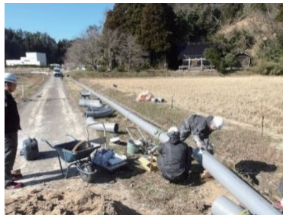
下水を集約し処理場へ送る圧送管の被災現場（珠洲市）
