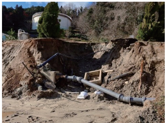
浄水場内の配管損傷（七尾市）
