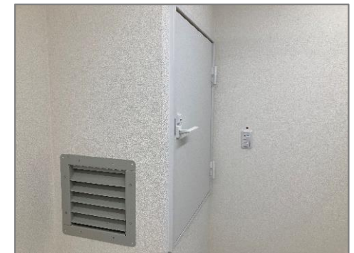
図 コンテナ内部の陰圧装置
