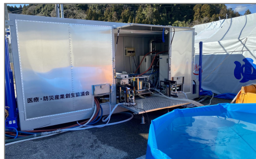
図 災害時におけるボイラーコンテナの状況
