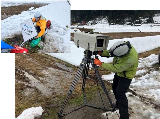
監視カメラ・Ku-SAT（衛星通信装置）設置状況（紅葉川）
