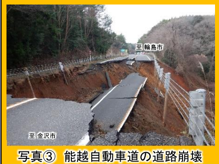
写真③ 能越自動車道の道路崩壊
