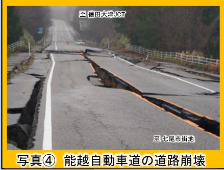
写真④ 能越自動車道の道路崩壊
