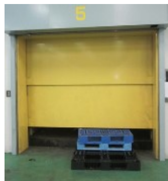
写真1 5階エレベーター乗り場
