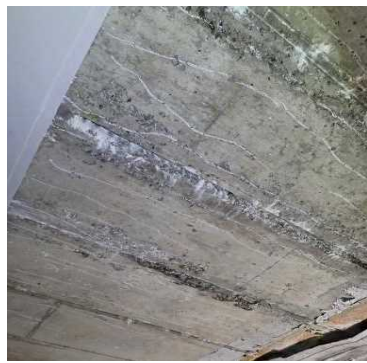
主桁のひび割れ
