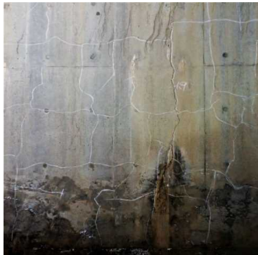
橋台のひび割れ
