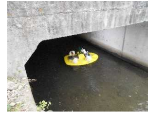
水上ドローンによる損傷把握
