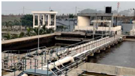
アラハバード・サロリ下水処理場及び 関連施設設計・建設・運転維持管理
