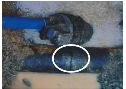
地中で折れた水道管
