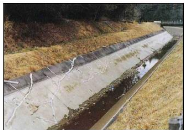
開水路のひびわれ
