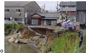
R5.6山中川の被災状況調査(愛知県豊橋市)
