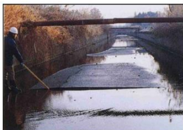
水路底の浮き上がり
