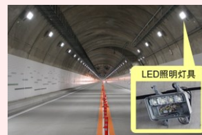
道路照明のLED化
