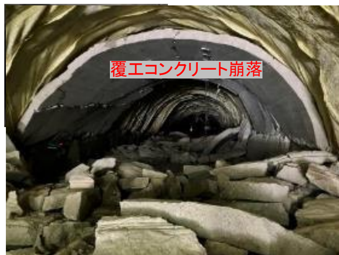
R6能登半島地震による被害の例 (道路の機能が喪失/大谷トンネル)
