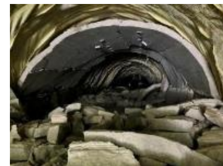
覆工コンクリート崩落(大谷トンネル)
