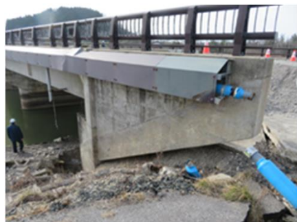
橋台背面盛土の沈下により抵抗特性が変化した事例
