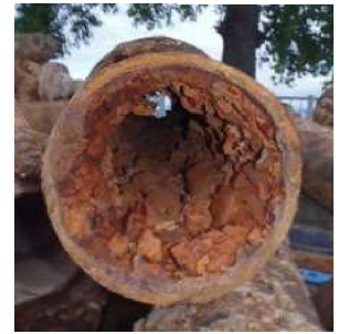
錆による水道管の腐食
