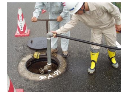
応急給水支援設備
