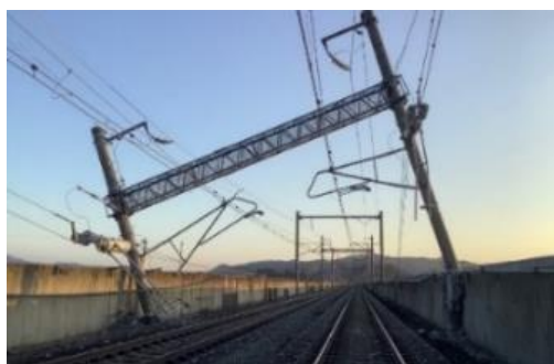
東北新幹線の電柱傾斜
