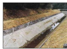
開水路のひびわれ
