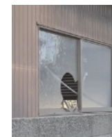
窓が割れた管理不全空家
