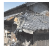
緊急代執行を要する崩落しかけた屋根
