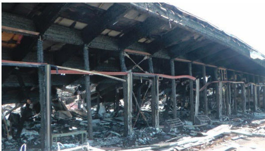
写真-I-1. 2. 1 火災による保育所の被害状況
