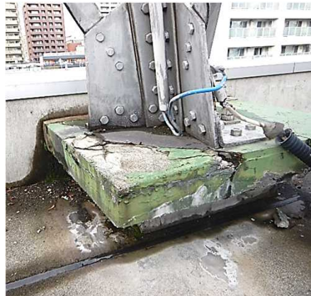
屋上鉄塔基礎: ひび割れ、爆裂が発生している
