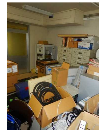
1Fサーバー室：収納場所が不足している
