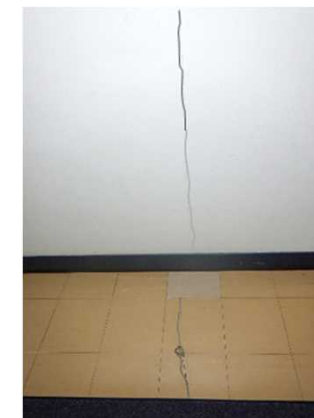
1F事務室: 床、壁にひび割れ、欠損が発生している
