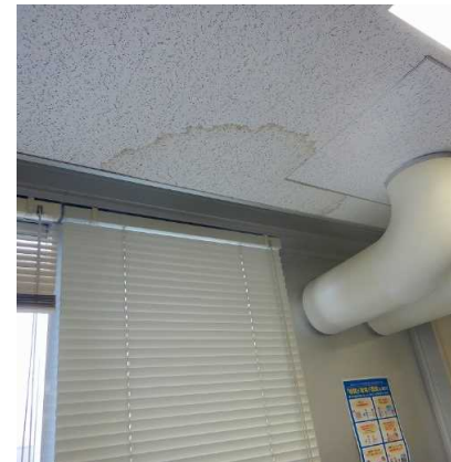
3F事務室: 天井に漏水がみられる
