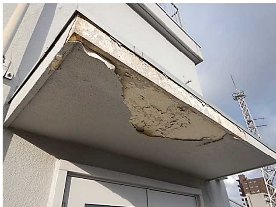
屋外庇: ひび割れ、爆裂が発生している
