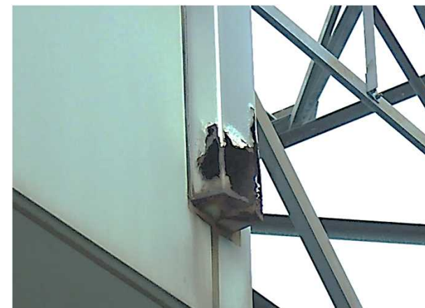
南面外壁: 建具が腐食している
