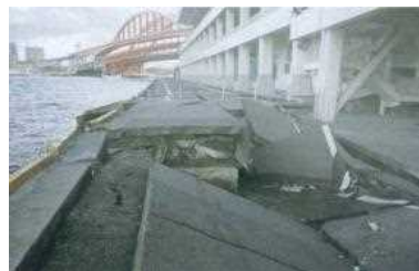
岸壁の被災(神戸港)
