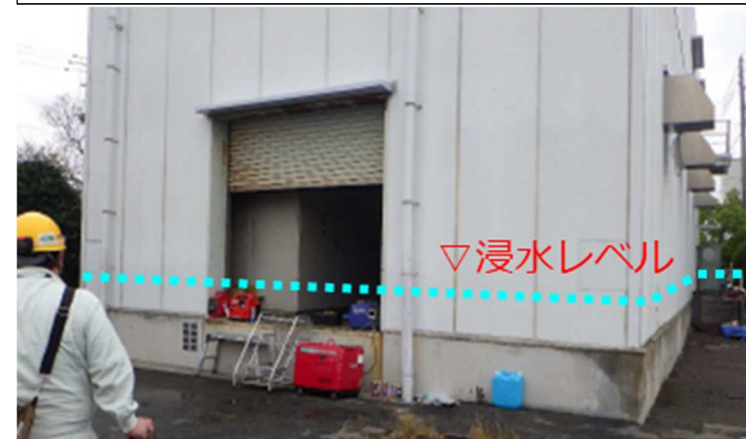
電源施設の浸水
