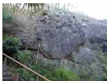
急傾斜地の落石危険箇所
