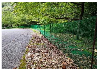
奄美大島の湯湾岳の一部の道路区間に施工された進入抑制フェンス
