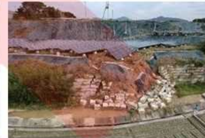
法面保護工が崩れて流出した事例
