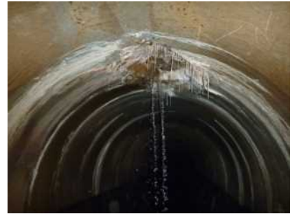
トンネル天頂部の欠損
