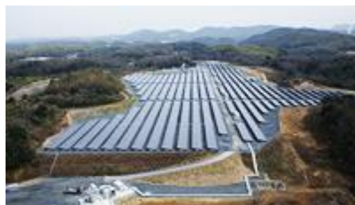
厚狭太陽光発電所
